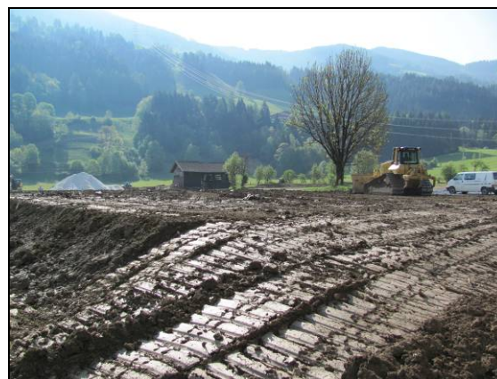
Nicht nur Bauland, auch einige Grünlandnutzungen wie z.B. Golfplätze können zu Konflikten mit dem Bodenschutz führen
