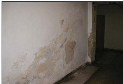
Abb. 17: Salzausblühungen in Folge eindringender Feuchtigkeit vom Untergrund
