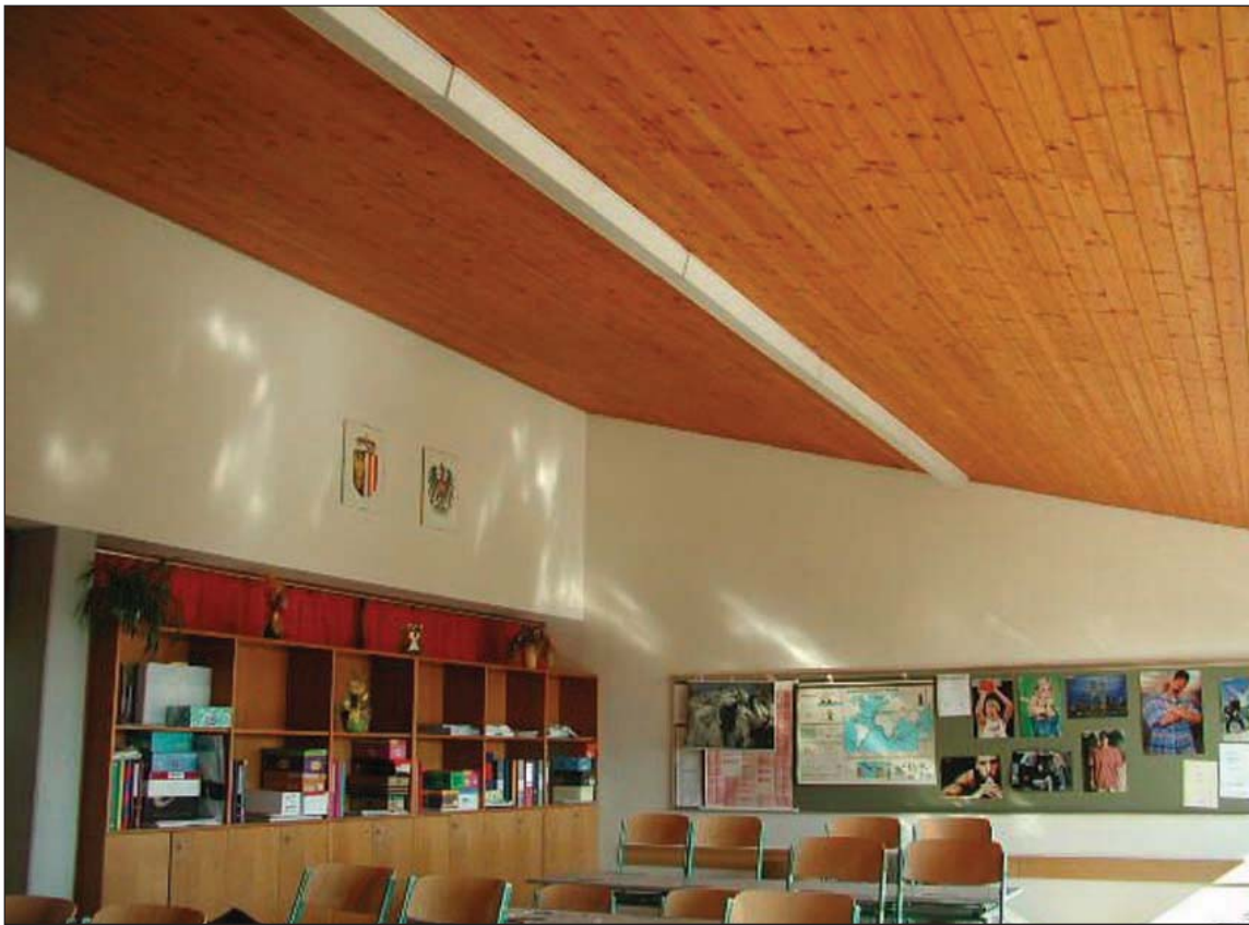
Abb. 10: Holzdecke mit hohen PCP-Konzentrationen in einer Schulklasse
